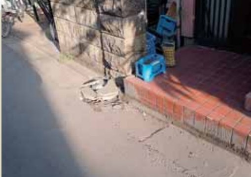
北千住西地域でマンホールから土砂が噴出
