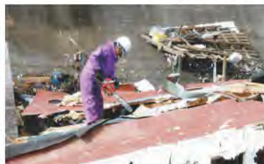
倒壊した屋根の上を切断し救助する岩手県宮古市の組合員
